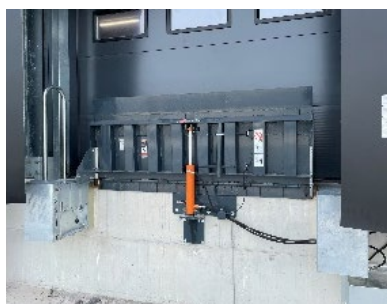
Pasarelas de carga
